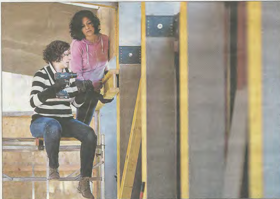
Dos voluntarias participan en la construcción de un comedor en el colegio Europa.
